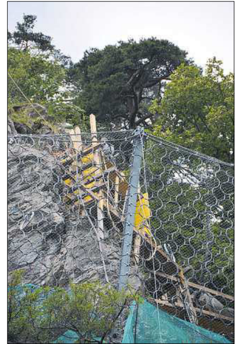
Hoch über den Netzen befindet sich die Schalung zur Erstellung der Betonpfeiler, welche der Sicherung des Felskopfes dienen.
