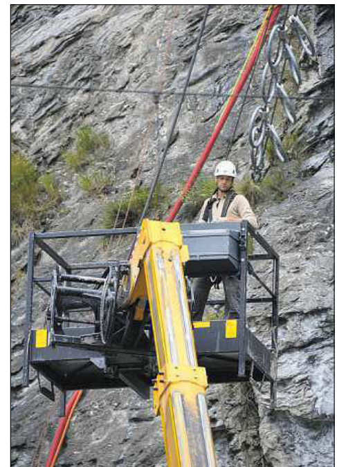
Mit dem per Funk gesteuerten Baukran gehts bis zu 90 Meter in die Höhe.
