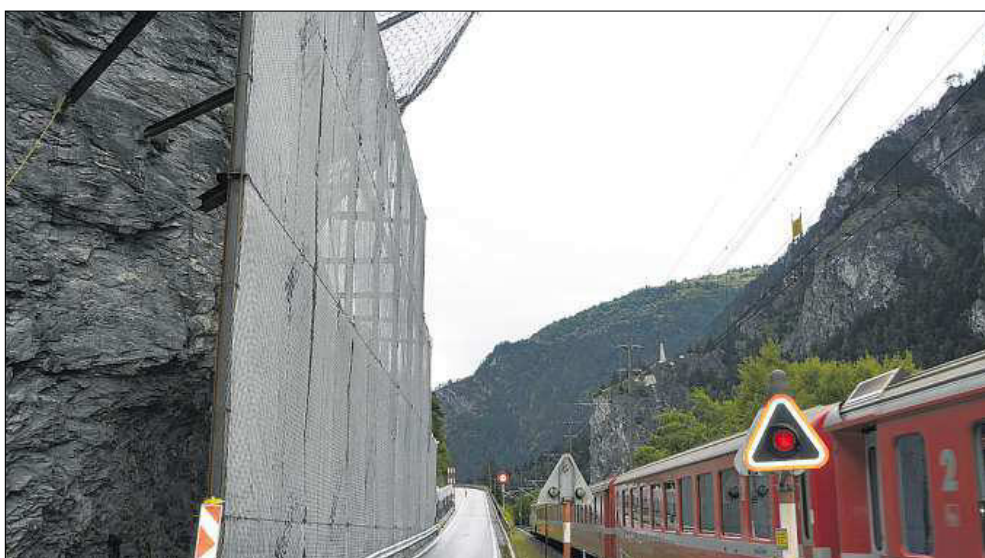
Die baulichen Massnahmen erhöhen den Schutz gegen Steinschlag für Strasse und Bahn.
